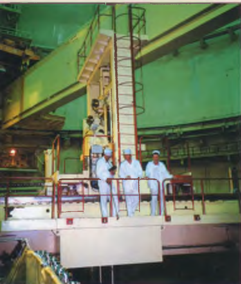
ЦЕНТРАЛЬНЫЙ ЗАЛ РЕАКТОРНОГО ОТДЕЛЕНИЯ ПЕРЕГРУЗОЧНАЯ МАШИНА
