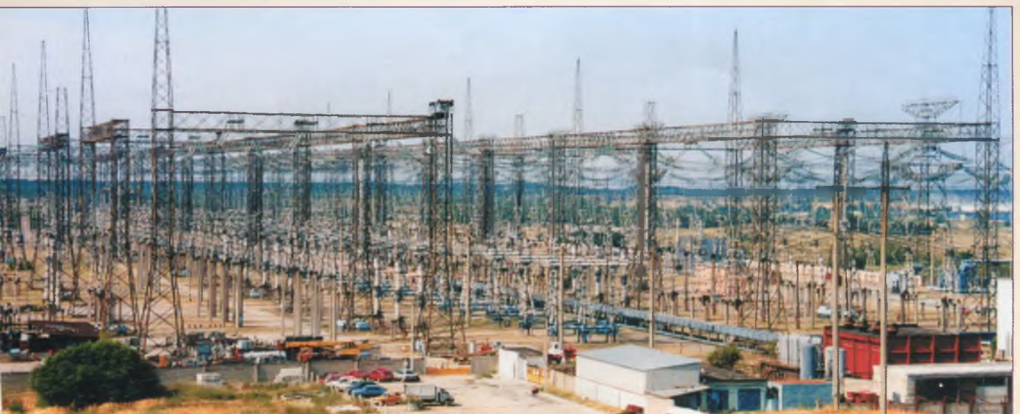
ОТКРЫТОЕ РАСПРЕДЕЛИТЕЛЬНОЕ УСТРОЙСТВО ОРУ-750
