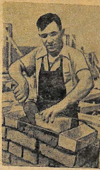
На знімку: передовий муляр БМУ-2 тов. СТОЛЬНОВ М. В. У дні святкової стахановської вахти він виконував норми виробітку на 130-140 процентів.
